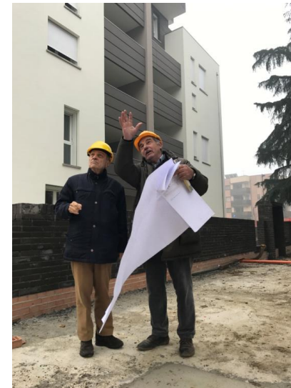
2015-2017: Ferretti e Neri costruiscono a San Lazzaro Savena il primo cantiere in Bologna con geotermia in
